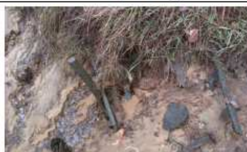
Trace d'un ancien confortement en pieux bois
