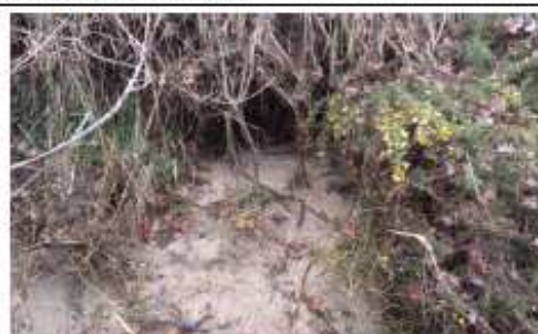
Cavité en pied de berge
