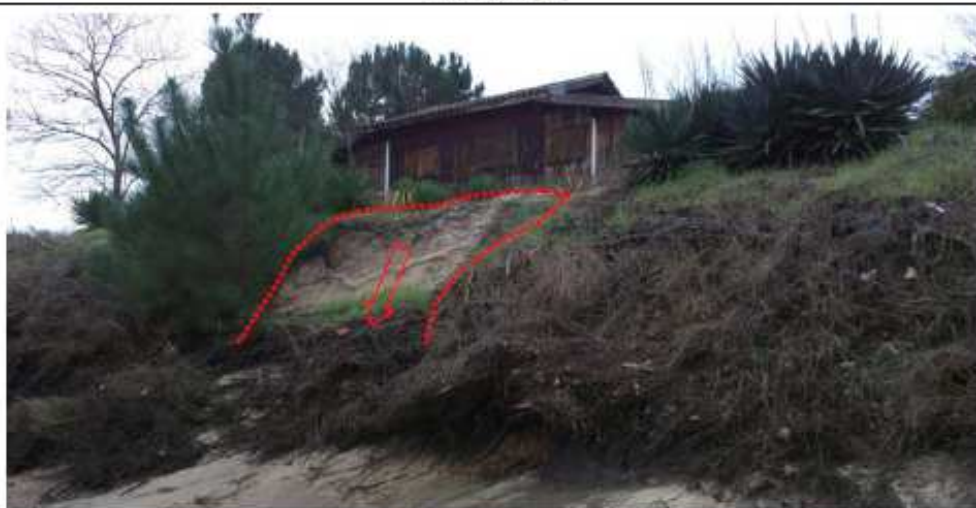
Zone de glissement en pied d'habitation
