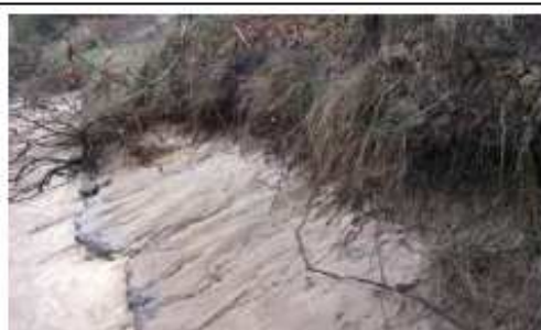
Affouillements en pied de berge
