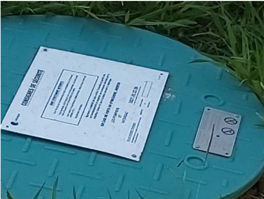
Tampon de visite après station : où vont les rejets ?
